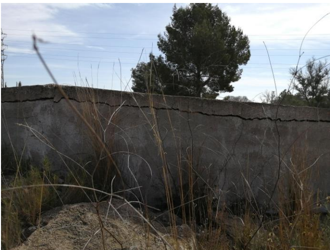
Foto 11 detall de la fissura lateral que hi ha a la paret més al nord.
